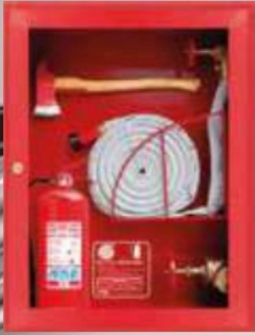
Gabinete contra incendios
